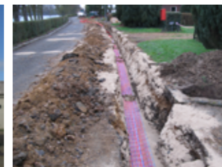
conduite d'eau potable au Parc de Loisirs
